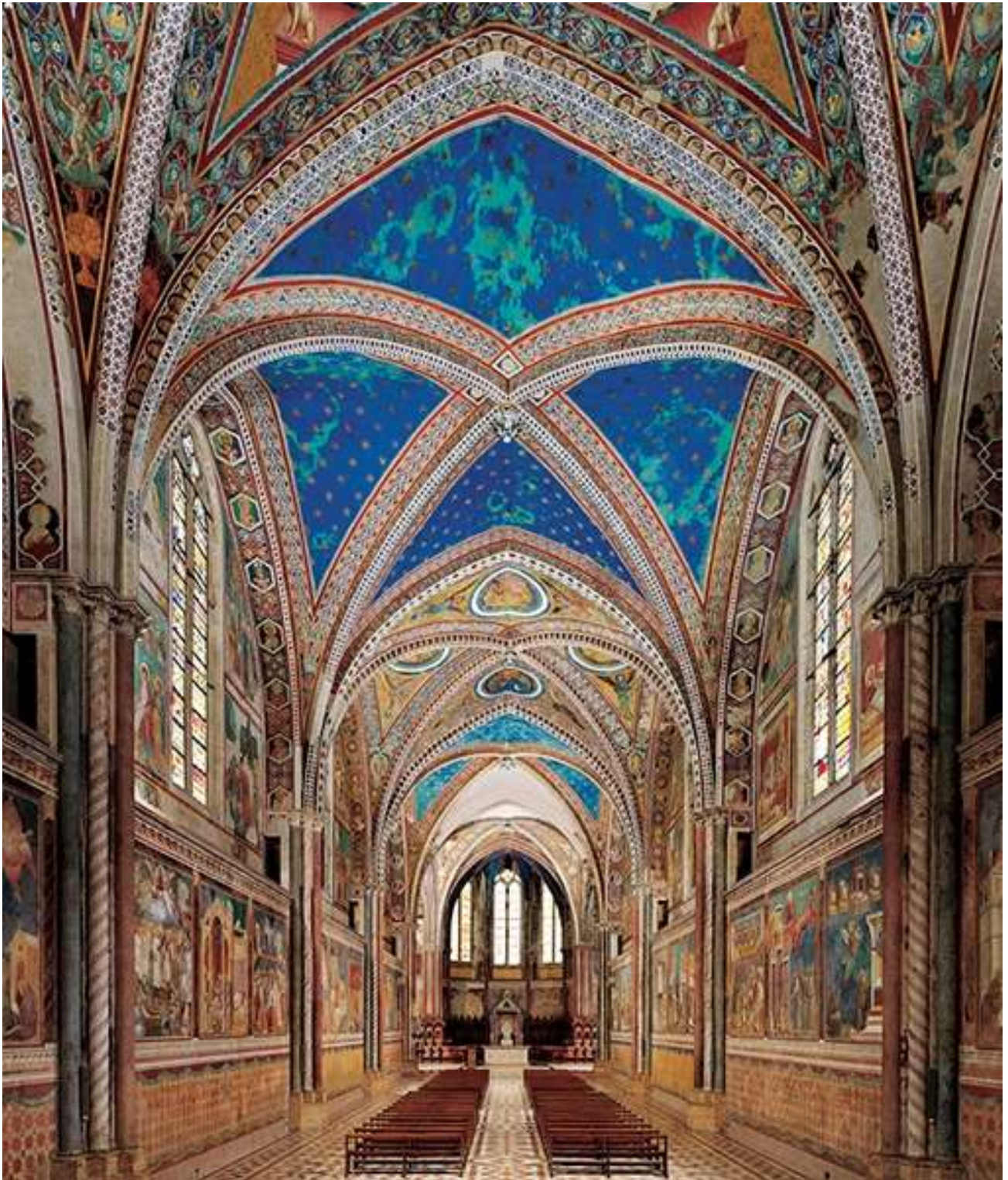
Fig.63: GIOTTO: AZZURRITE TRASFORMATA IN MALACHITE VERDE A CAUSA DELL'UMIDITA' O DI INFILTRAZIONI DI ACQUA.
